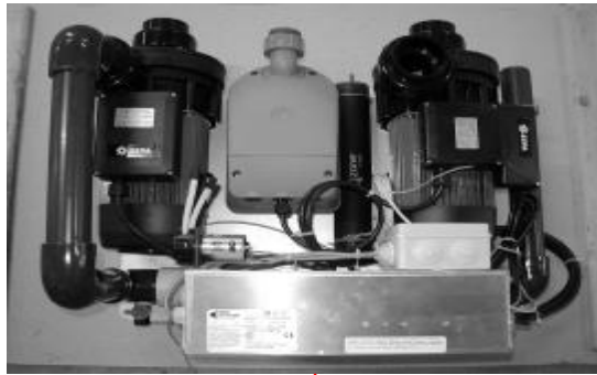
Accès au coffret électrique
